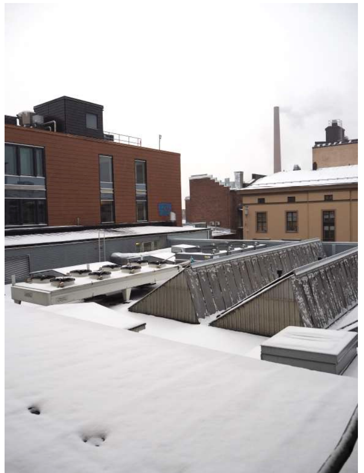
3. kerroksen vesikatto. Kattoikkunat ovat edelleen paikallaan. 2025 . (EH)
