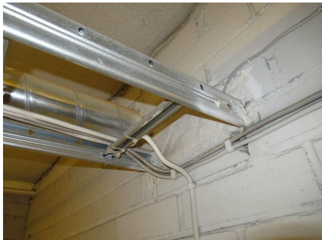
Virallinen paloläpivienti asentajan kuittaamana
