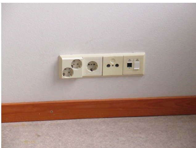
Asuinhuoneiston yleiskaapelointipiste oikealla
