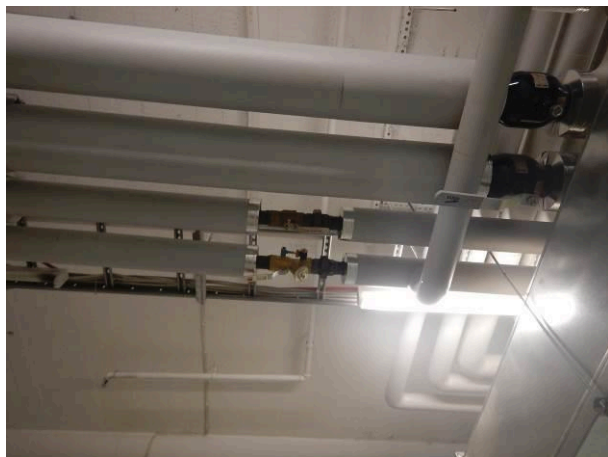
Lämpöjohtoverkoston sulku- ja säätöventtiilit.
